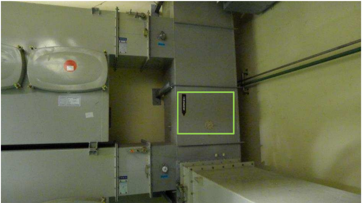
Figure 7 Vue de la gaine amont avec ses prises et Pneurops
