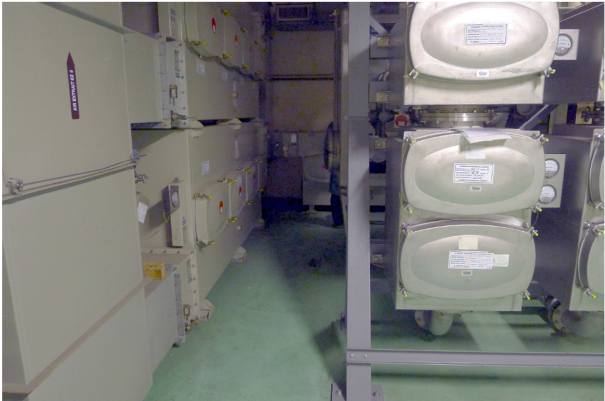
Figure 6 A gauche, les caissons 220FT020 et 220FT021 (en-dessous) avec les registres 220RN151 (au-dessus) et 220RN151 (en-dessous) permettant de les isoler de la gaine aval. A l'arrière-plan, une partie du caisson triple 220FT022 et son registre amont 220RN154.
