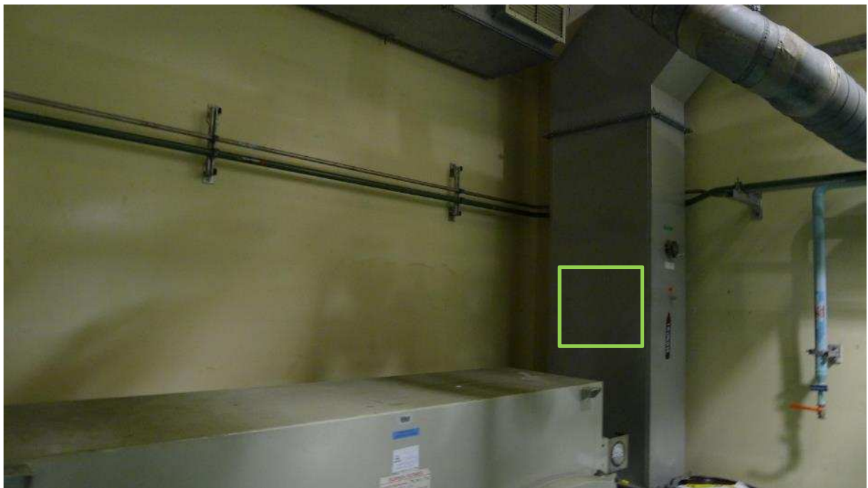
Figure 8 Vue de la gaine aval aux caissons triples avec ses prises et Pneurops à déplacer (la gaine spiralisée en acier galvanisée est celle du soufflage)
