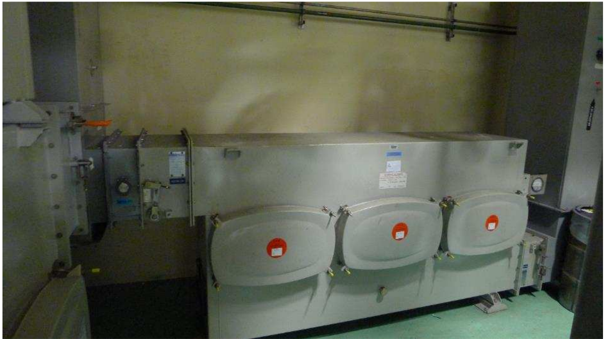
Figure 5 Le caisson triple 220FT022 sur lequel sera installé le nouveau
